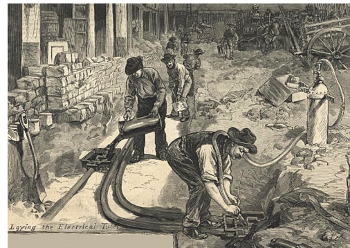
Interramento di cavi a corrente continua della Edison a New York nel 1882.
